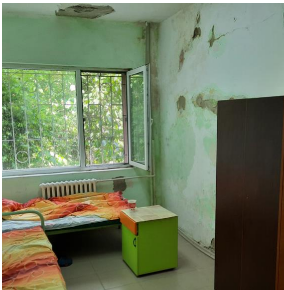
Стая с нужда от спешен ремонт
