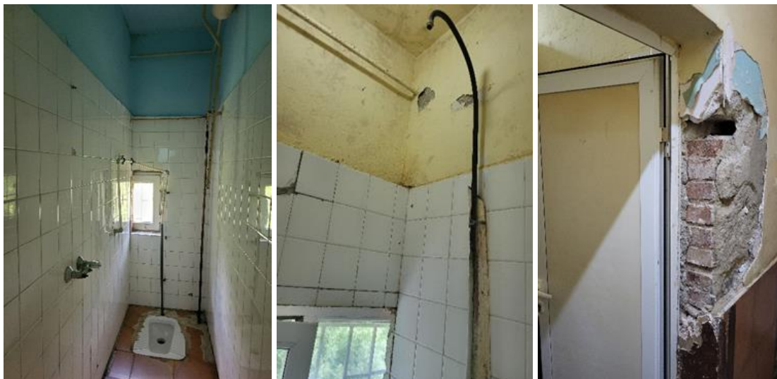
Санитарни помещения в ДПБ - Карвуна, нуждаещи се от спешни ремонтни дейности
